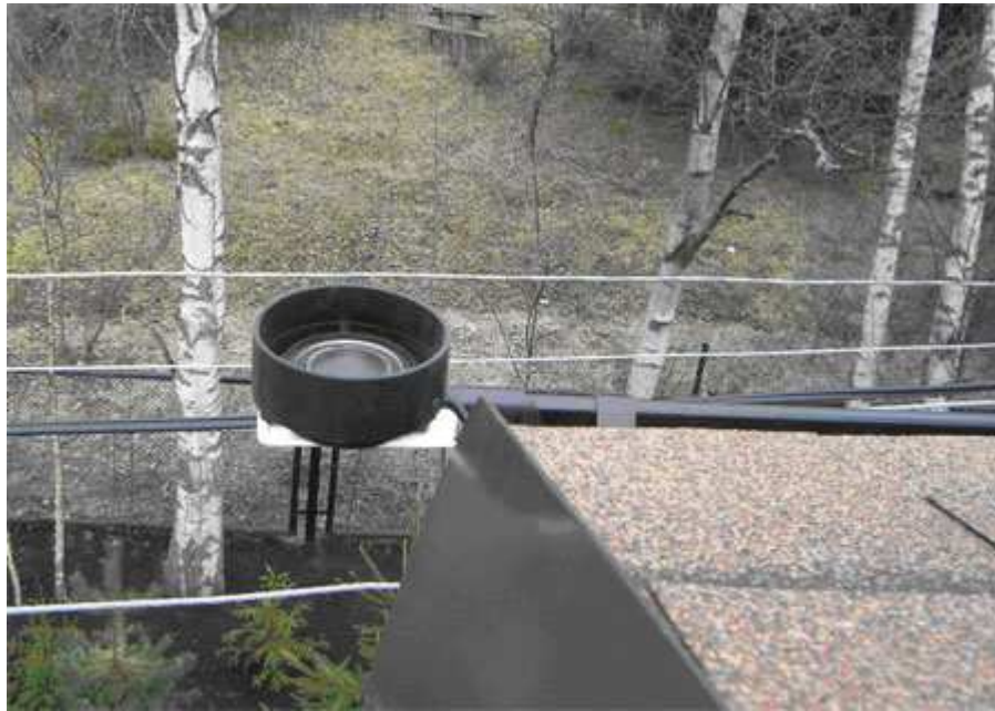
Датчик осадков, установленный на кровле
